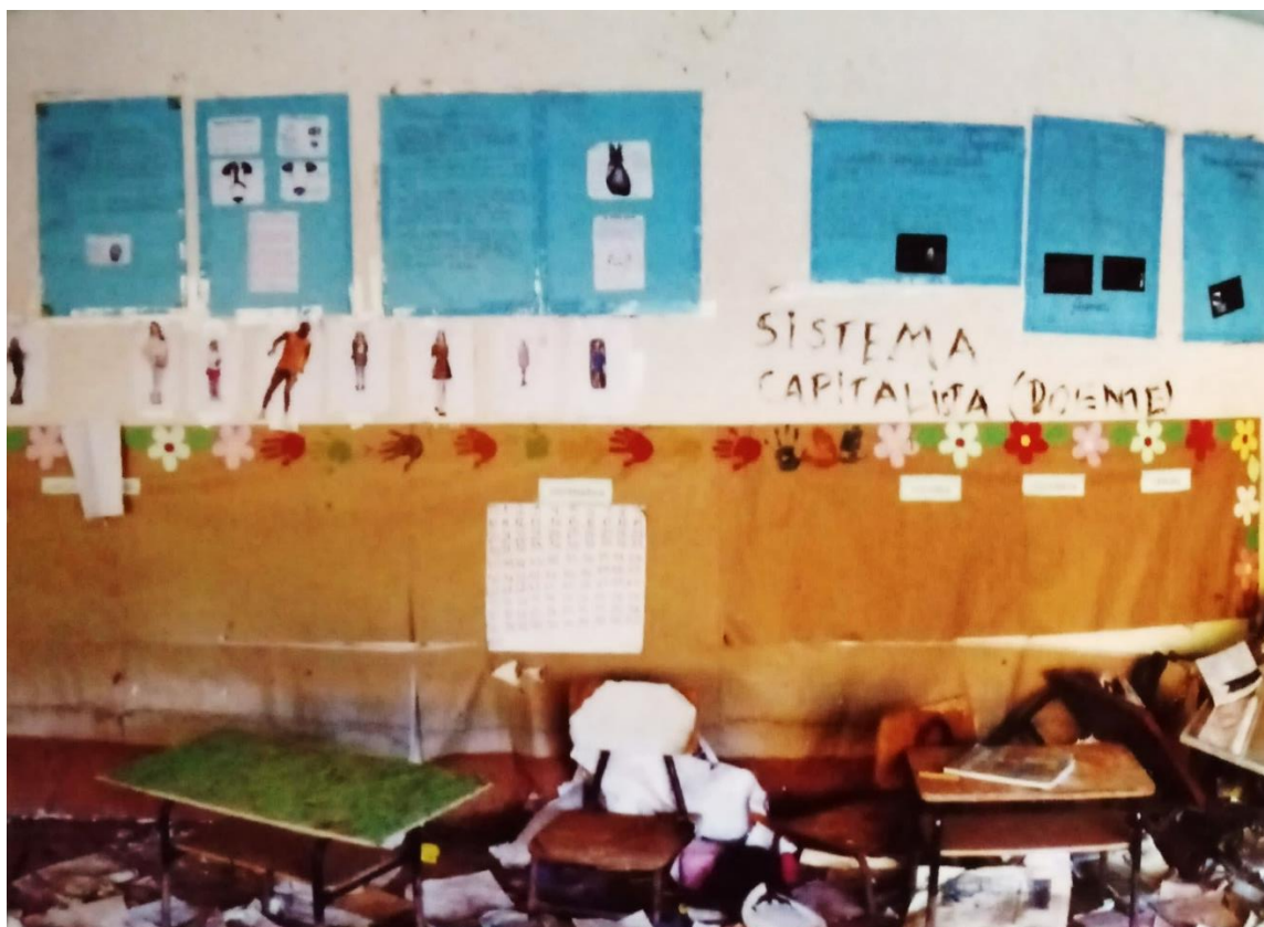
Figura 2: Lógica dilapidadora: “As mãozinhas dos alunos na parede que a lama não alcançou”.
