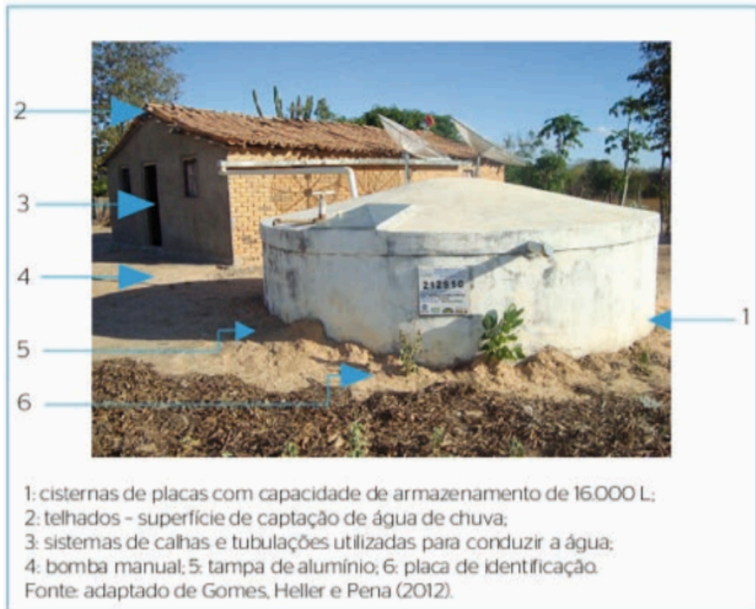
Figura 4. Sistema de captação de água da chuva do P1MC. Fonte: Nogueira, 2017.
