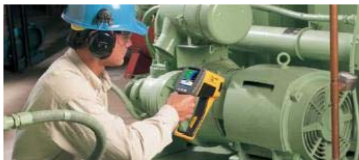
Figura 2.6- Inspeção termográfica dos enrolamentos de um motor elétrico.
