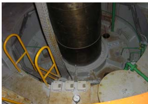
Figura 5.4- Eixo e mancal guia da turbina.
