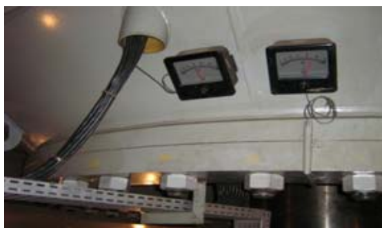
Figura 5.5- Indicadores de temperatura do metal e do óleo do mancal combinado.
