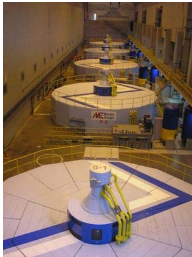
Figura 5.2- Vista superior das 5 unidades geradoras.
