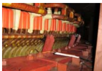
Figura 5.8- Sonda de temperatura do enrolamento do estator.
