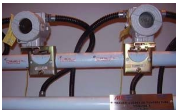
Figura B.1- Transmissores de temperatura do mancal guia da turbina.
