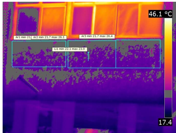
Figura C-8: Descolamento cerâmico no momento de máximo contraste. Fachada Leste 1 região G2.
