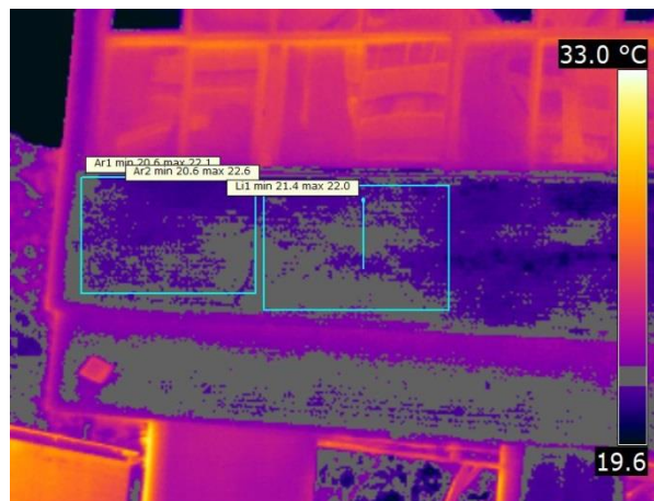
Figura D-47: Descolamento cerâmico no momento de máximo contraste. Fachada Oeste 6 região G2.
