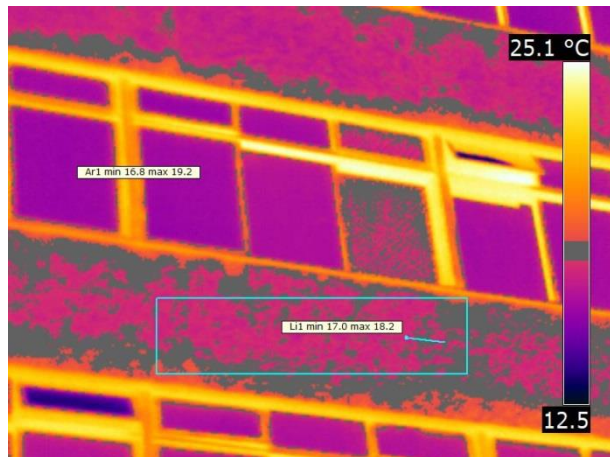
Figura B-30: Descolamento cerâmico no momento de máximo contraste. Fachada Sul 2 região E2.
