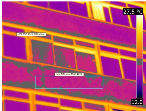
Figura B-28: Descolamento cerâmico no momento de máximo contraste. Fachada Sul 2 região D2.
