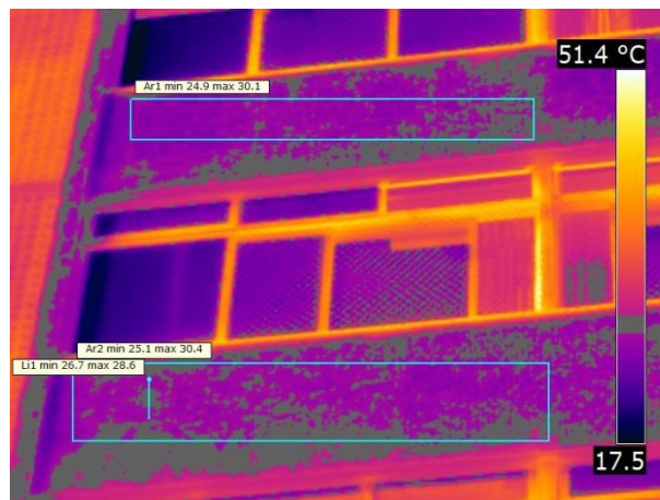
Figura B-3: Descolamento cerâmico no momento de máximo contraste. Fachada Norte região D1.
