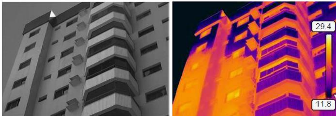
Figura 6: Presença de reflexo afetando os valores de temperatura da fachada (BAUER et al., 2015).
