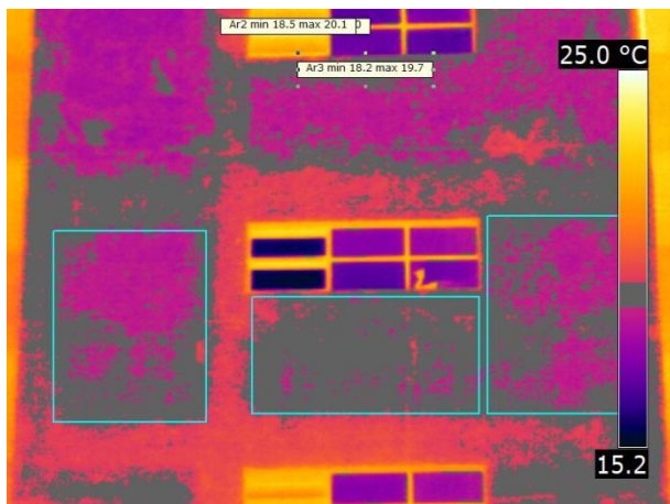
Figura B-13: Descolamento cerâmico no momento de máximo contraste. Fachada Caixa Sul região E1.
