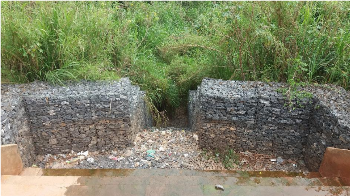
Figura 18 – Dissipador de energia.
