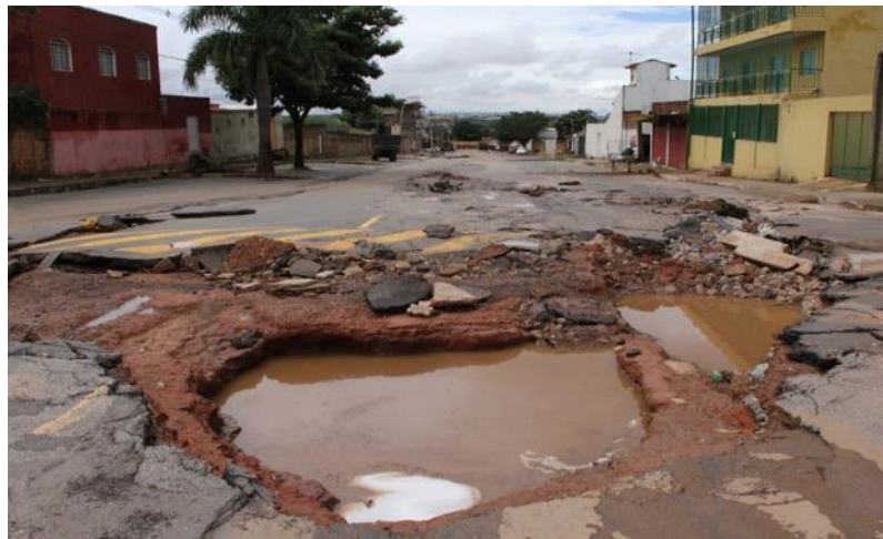
Figura 7 – Buraco provocado pela chuva na Rua 10 de Vicente Pires.
