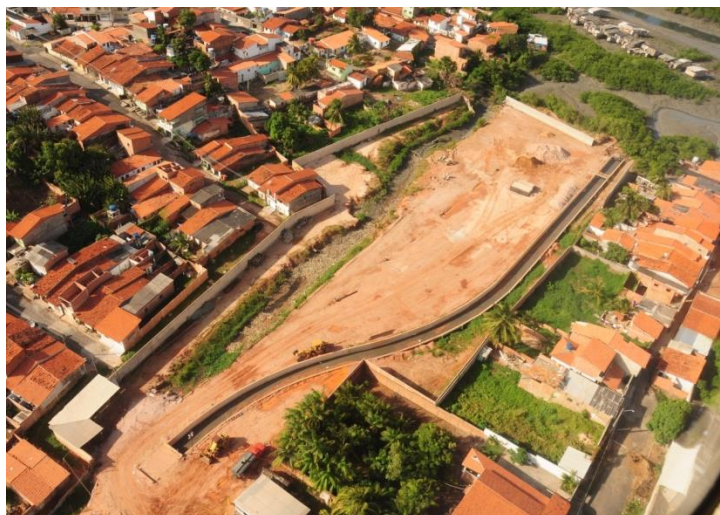
Figura 39 - Foto da visão geral da área da estação de tratamento de esgoto do Anil. Fonte: CAEMA, 2018a.
