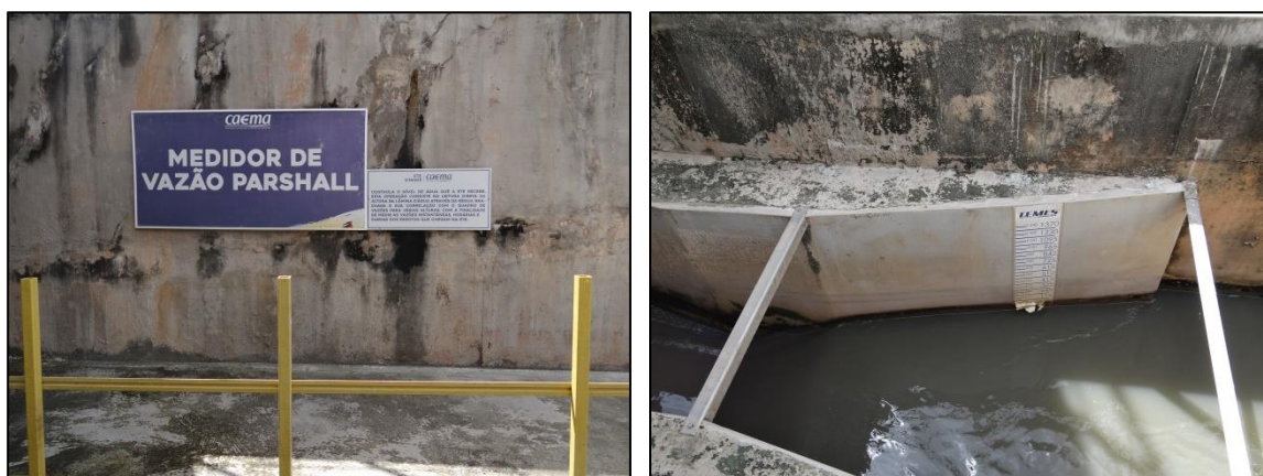
Figura 45 - Medidor de vazão Parshall na entrada da elevatória final da ETE Vinhais. Fonte: Autoria própria.
