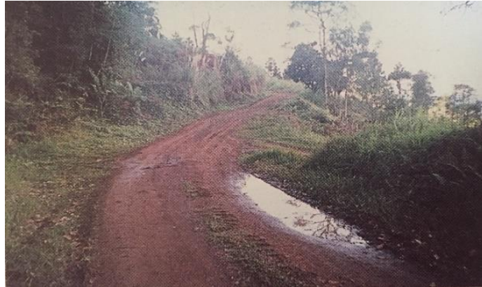
Figura 2.2: Drenagem inadequada (Baesso & Gonçalves, 2003).
