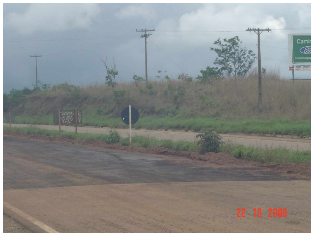
Figura 6.9 - Visão geral do trecho sem erosão - coord. S 16° 06' 41,87" e W 48° 18' 20,97"
