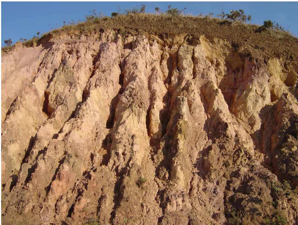
Figura 1.3 - Erosão localizada às margens da BR-080, próximo à DF-220
