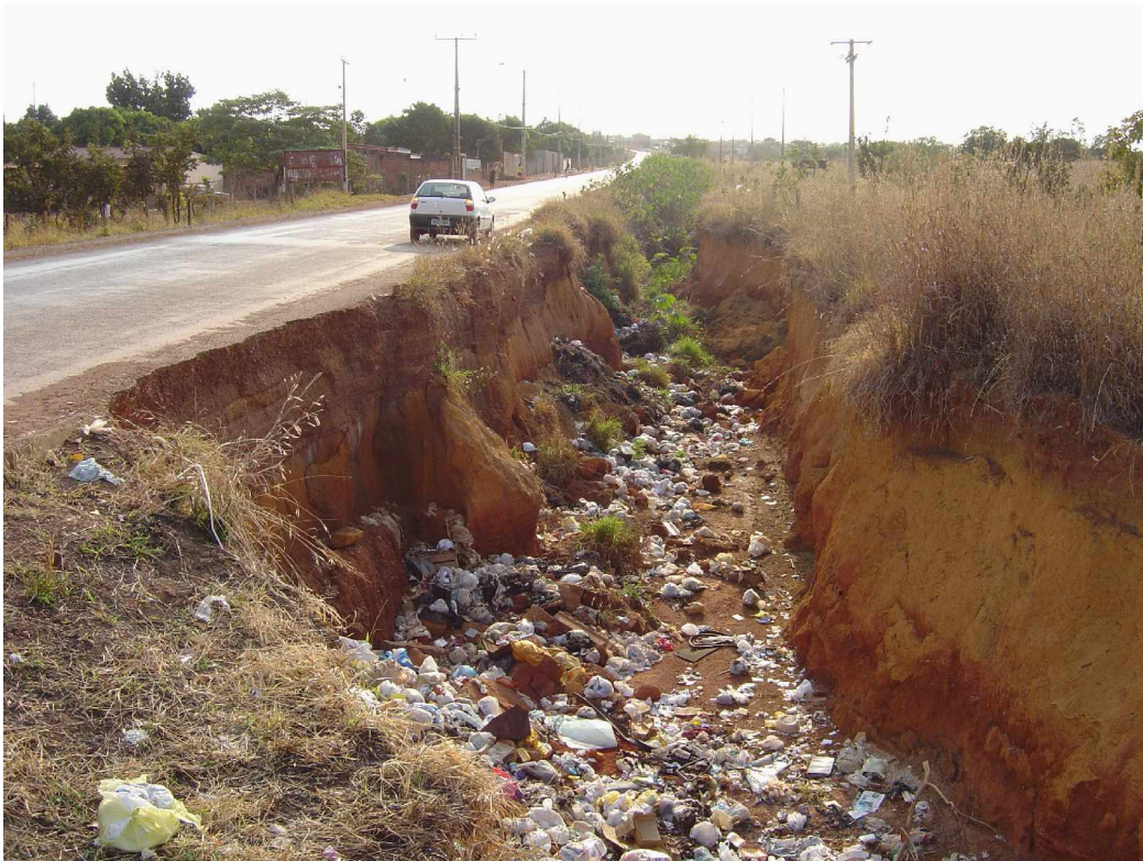
Figura 1.5 - Erosão localizada às margens da BR-080, próximo à cidade de Santo Antônio do Descoberto - DF
