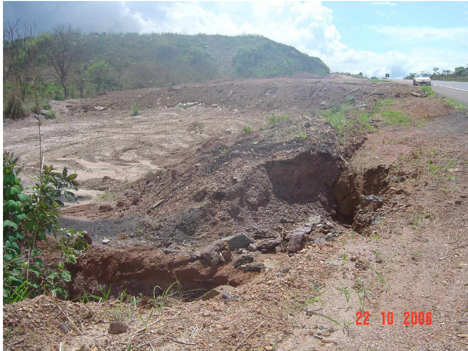
Figura 6.16 - Visão geral trecho com erosão - coord. S 16° 00' 48,70" e W 48° 09' 52,94"
