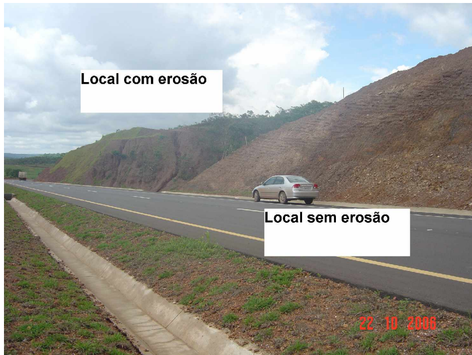
Figura 6.12 - Visão geral do trecho de transição com e sem processos erosivos. Coordenadas S 16° 02' 37,10" e W 48° 15' 26,29"
