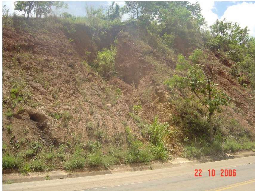
Figura 6.24 - Visão geral talude com erosão - cd. S 15° 33' 36,03" e W 48° 11' 48,61"
