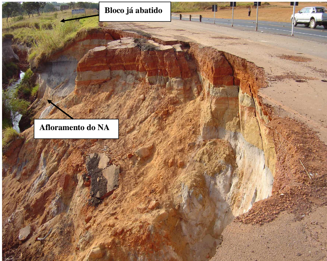
Figura 1.1 - Voçoroca localizada na BR-070, próximo a cidade de Brazlândia - DF
