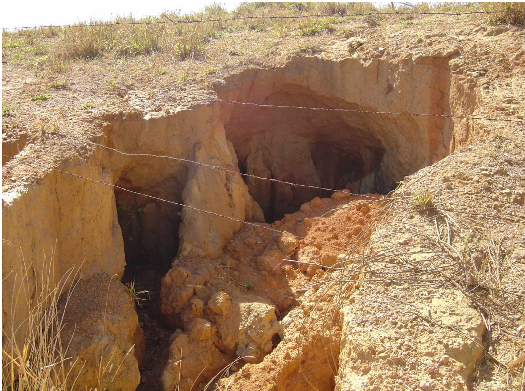
Figura 1.2 - Erosão localizada na BR-080, próximo à cidade de Brazlândia – DF
