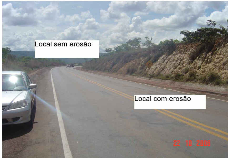
Figura 6.26 - Visão geral do trecho de transição com e sem processos erosivos. Coordenadas S 15^{\circ} 36' 18,62'' e W 48^{\circ} 11' 53,66''
