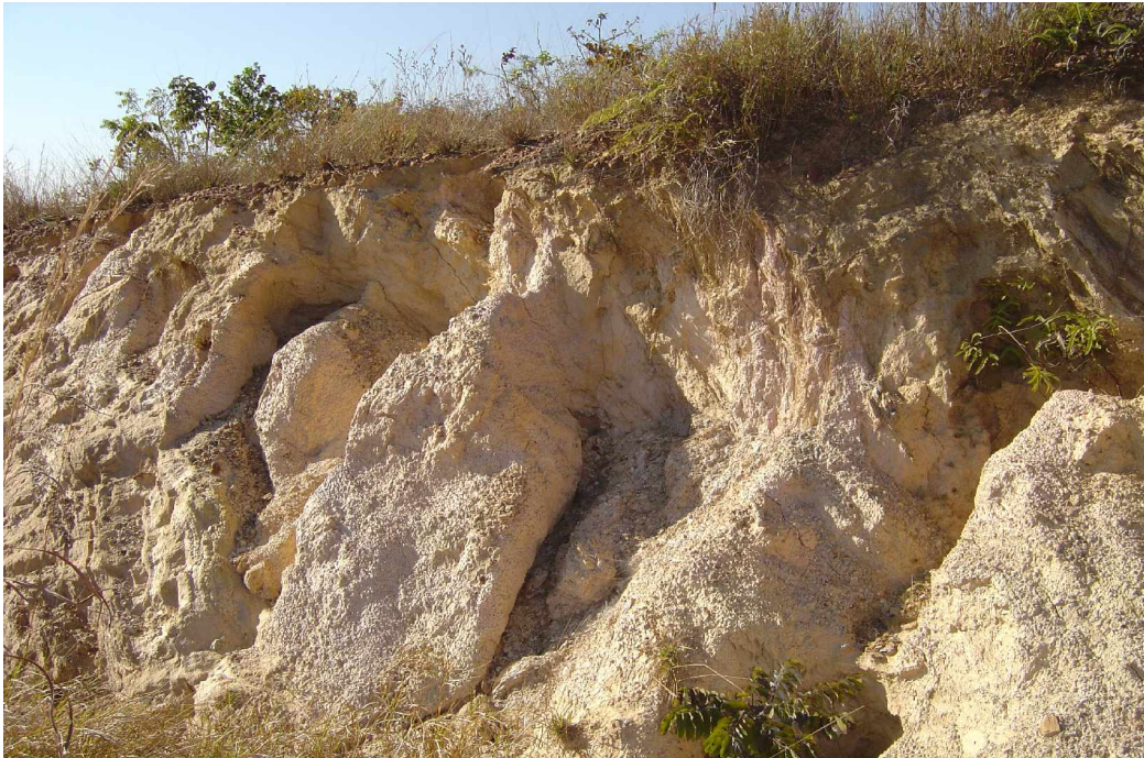
Figura 1.4 - Erosão localizada na BR-060, próximo ao Rio Areias – GO
