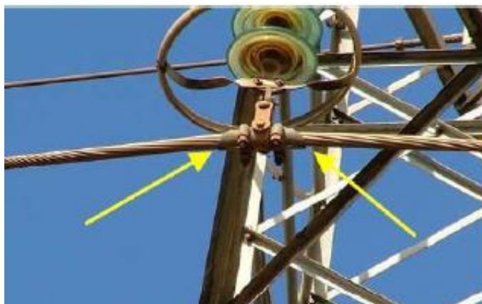
Figura 1.1. Cabo condutor e grampo de suspensão numa linha de transmissão (EPRI, 2006).
