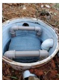
Figura 61: reuso de água (cozinha), EC 05, 23/08/2017.
