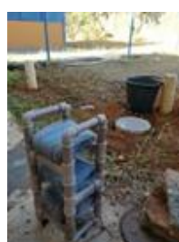
Figura 62: reuso de água (cozinha), EC 05, 23/08/2017.
