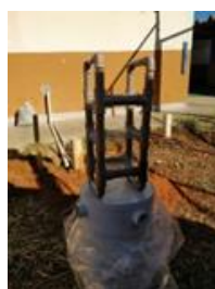
Figura 60: reuso de água (cozinha), EC 05, 23/08/2017.
