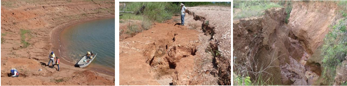
Figura 4.6 Processos erosivos nas margens do reservatório da UHE Itumbiara (Sales, 2016)
