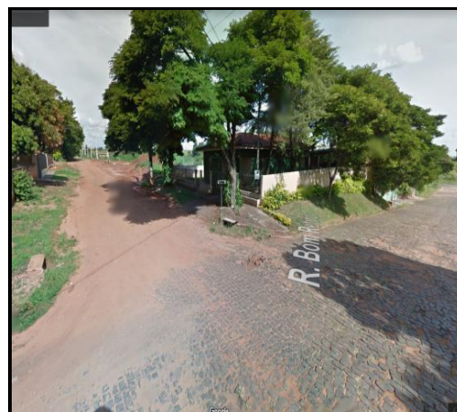
Figura 133 – Pavimento precário e falta de pavimentação Fonte: Google maps (imagens 2017)
