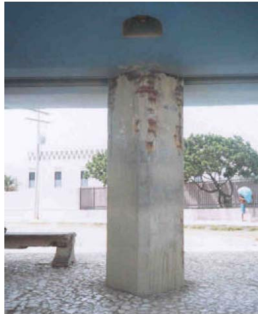
Fig. 10 - Corrosão na parte superior do pilar ( F_i=3 )
