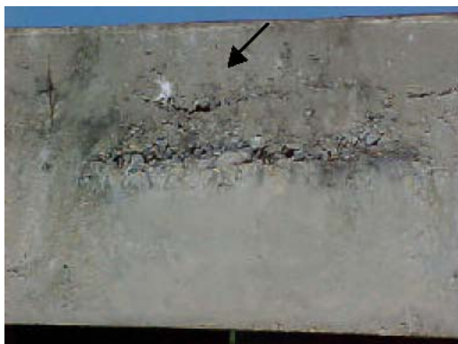
Fig. 38 – Falha de concretagem (Fi=2)
