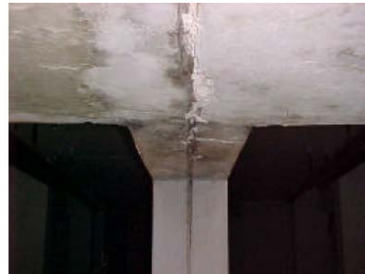
Fig. 33 - Obstrução da junta de dilatação ( F_i=3 )
