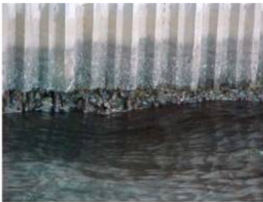
Fig. 13 - Desagregação do concreto ( F_i=4 )
