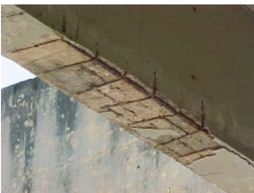
Fig. 3: Cobrimento deficiente ( F_i=3 ); Deslocamento ( F_i=4 )
