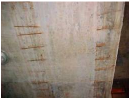
Fig. 2: Cobrimento deficiente ( F_i=2 )
