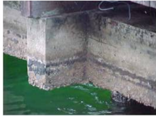
Fig. 15 - Desagregação do concreto ( F_i=3 )
