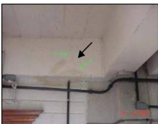
Fig. 26 - Fissura de cisalhamento ( F_i=2 )
