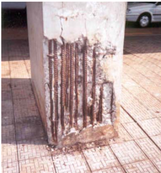
Fig. 9 - Corrosão ( F_i=4 ) Deslocamento ( F_i=4 )
