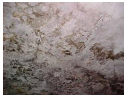
Fig. 29 - Umidade generalizada na laje ( F_i=4 )
