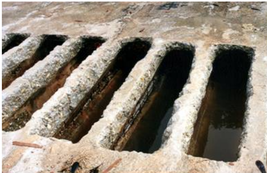
Figura 4.22: Caixões perdidos da laje cheios de água. (Walter Vilhena, 1992)
