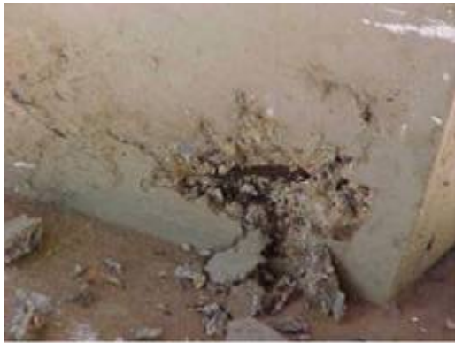
Fig. 7 - Corrosão ( F_i=3 )/Esfoliação (deslocamento no pé do pilar ( F_i=3 ))
