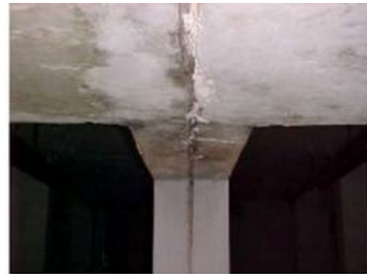
Fig. 33 - Obstrução da junta de dilatação ( F_i=3 )
