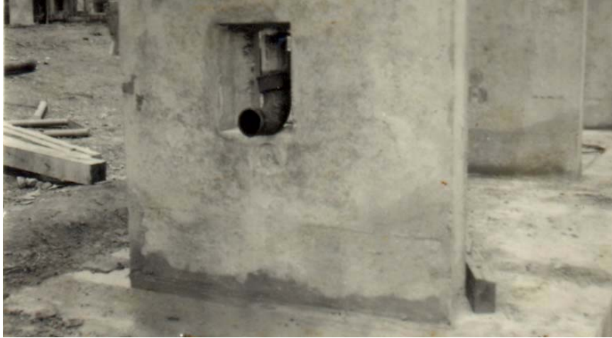
Figura 4.9: Tubo para descida de água pluvial. (Cedoc, 2006)
