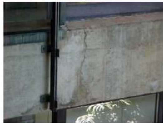
Fig. 22 - Fissura em viga ( F_1=3 )
