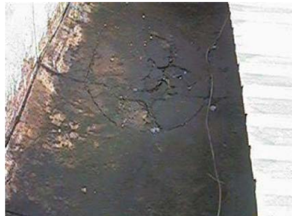
Fig. 27 - Impermeabilização degradada (calha em laje de cobertura) ( F_i=4 )
