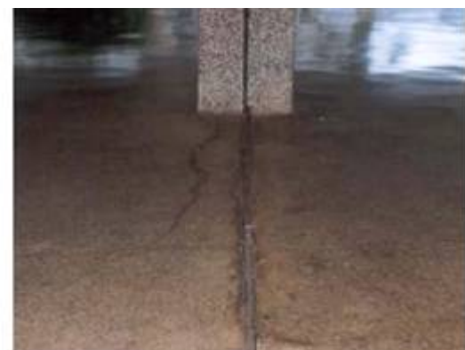
Fig. 35 - Obstrução de juntas de dilatação ( F_i=3 )
