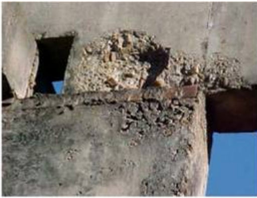
Fig. 12 - Desagregação do concreto na viga ( F_i=4 ) e segregação no pilar ( F_i=1 )
