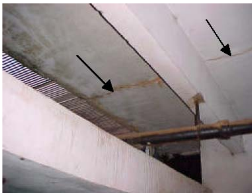
Fig. 25 - Fissura em laje ( F_i=3 )
