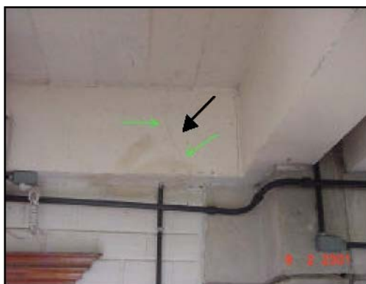
Fig. 26 - Fissura de cisalhamento ( F_i=2 )
