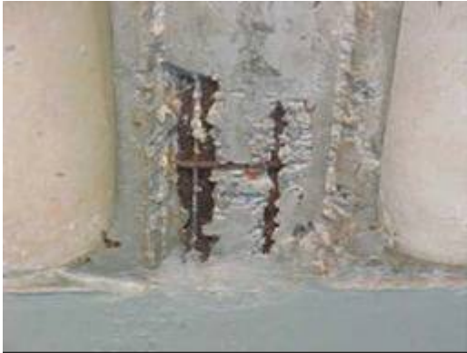
Fig. 1: Cobrimento deficiente ( F_i=3 )
