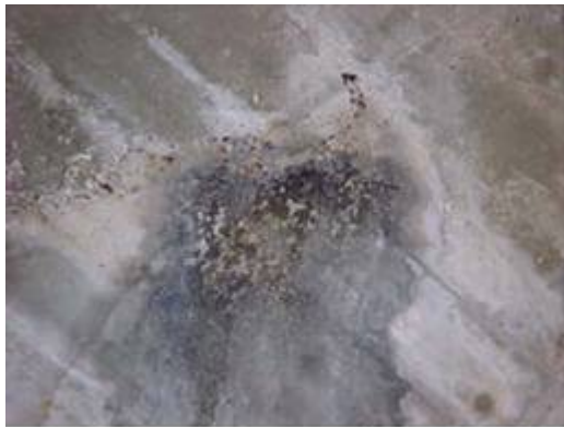
Fig. 30 - Infiltração ( F_i=3 ) / eflorescência ( F_i=3 )
