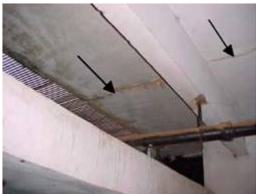
Fig. 25 - Fissura em laje ( F_i=3 )
