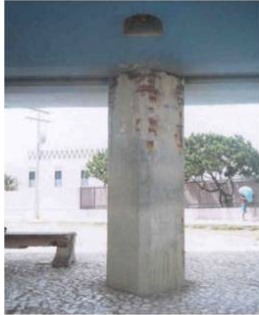
Fig. 10 - Corrosão na parte superior do pilar ( F_i=3 )
