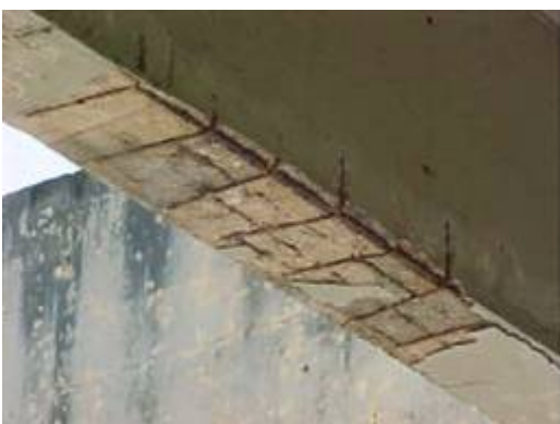
Fig. 3: Cobrimento deficiente ( F_i=3 )
