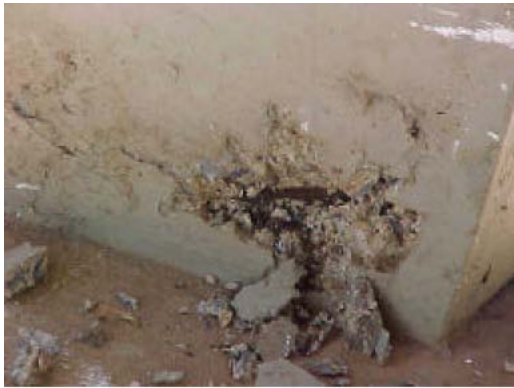
Fig. 7 - Corrosão ( F_i=3 ), (deslocamento no pé do pilar ( F_i=3 ))
