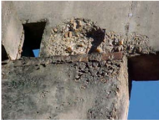
Fig. 12 - Desagregação do concreto na viga ( F_i=4 ) e Falha de concretagem no pilar ( F_i=1 )
