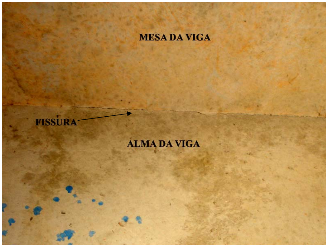
Figuras 5.11: Fissura entre a mesa e a alma das vigas de cobertura. (2007)
