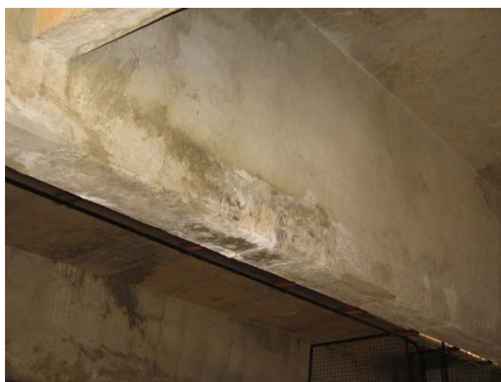
Figura 5.9: Eflorescência em viga. (Andrade, 2006)
