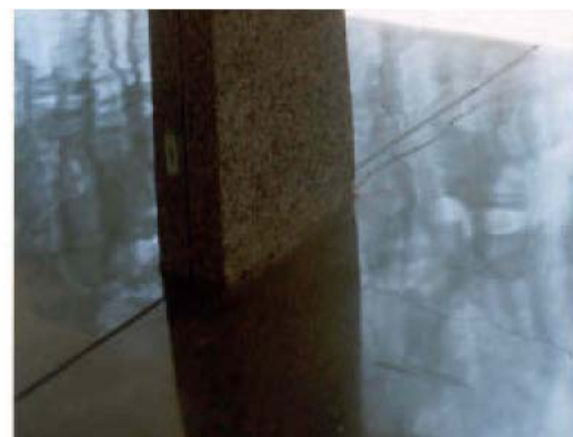
Fig. 34 - Obstrução de juntas de dilatação ( F_i=3 )
