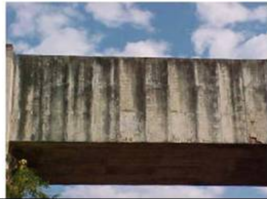
Fig. 4: Corrosão ( F_i=2 ); Esfoliação ( F_i=3 )
