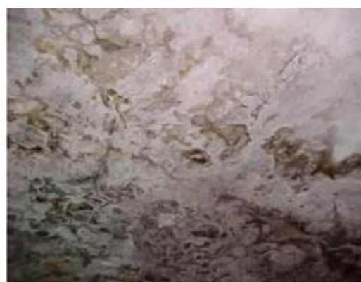
Fig. 29 - Infiltração generalizada em laje ( F_i=4 )
