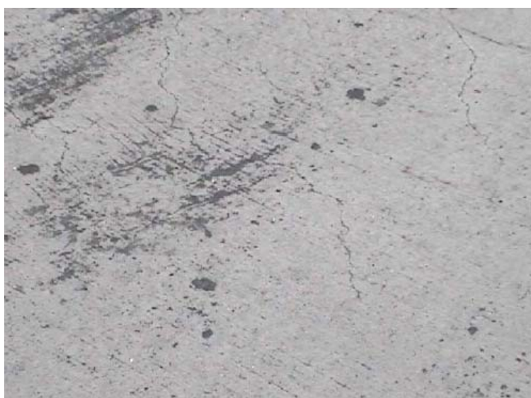
Figura 3.3: Fissuras de retração Plástica. (DNIT, 2004)
