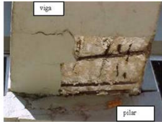
Fig. 39 - Sinais de esmagamento no concreto do pilar (Fi=3) e corrosão na viga (Fi=4)
