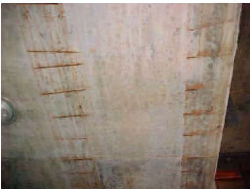
Fig. 2: Cobrimento deficiente ( F_i=2 )
