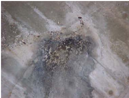
Fig. 30 - : Umidade ( F_i=3 )/ eflorescência ( F_i=3 )
