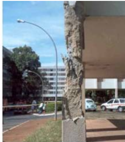
Fig. 40 - Sinais de esmagamento do concreto em pilar com flambagem da armadura (Fi=4)
