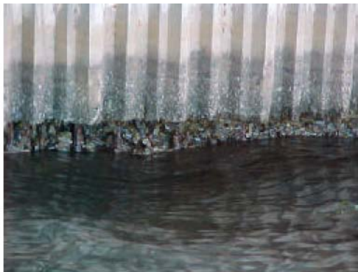
Fig. 13 - Desagregação do concreto ( F_i=4 )
