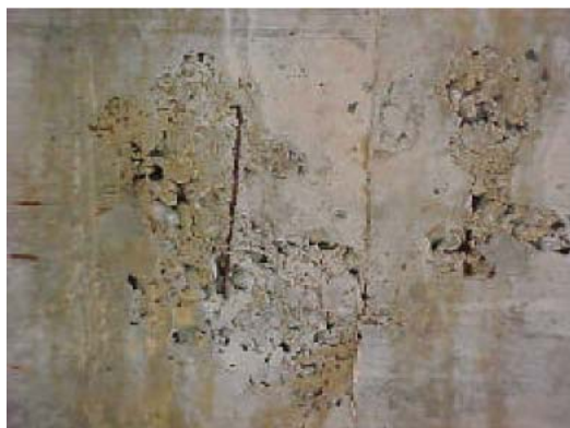
Fig. 36 – Falha de concretagem (Fi=2)
