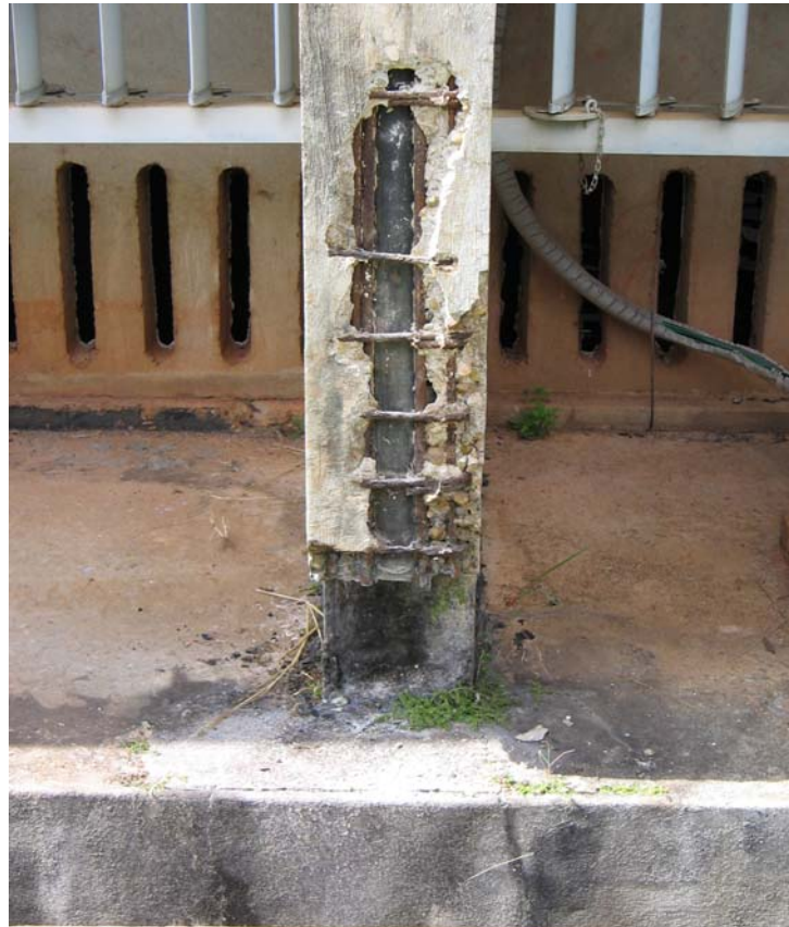
Figura 5.3: Corrosão na base do pilar com deslocamento do concreto. (Andrade, 2006)
