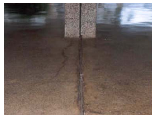
Fig. 35 - Obstrução de juntas de dilatação ( F_i=3 )
