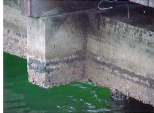
Fig. 15 - Desagregação do concreto ( F_i=3 )
