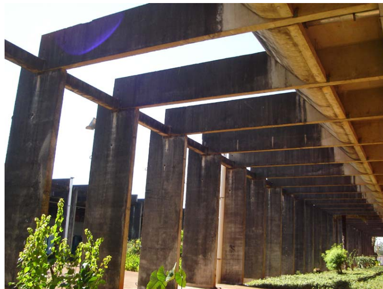
Figura 5.7: Manchas nas vigas e pilares
