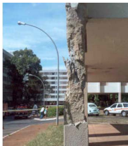
Fig. 40 – sinais de esmagamento do concreto em pilar com flambagem da armadura (Fi=4)
