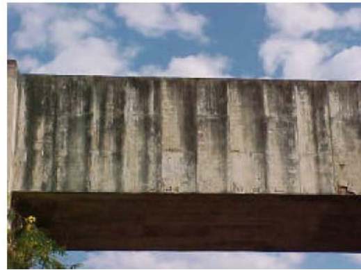
Fig. 4: Corrosão ( F_i=2 ); Deslocamento ( F_i=3 )
