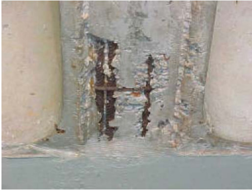
Fig. 1: Cobrimento deficiente ( F_i=3 )
