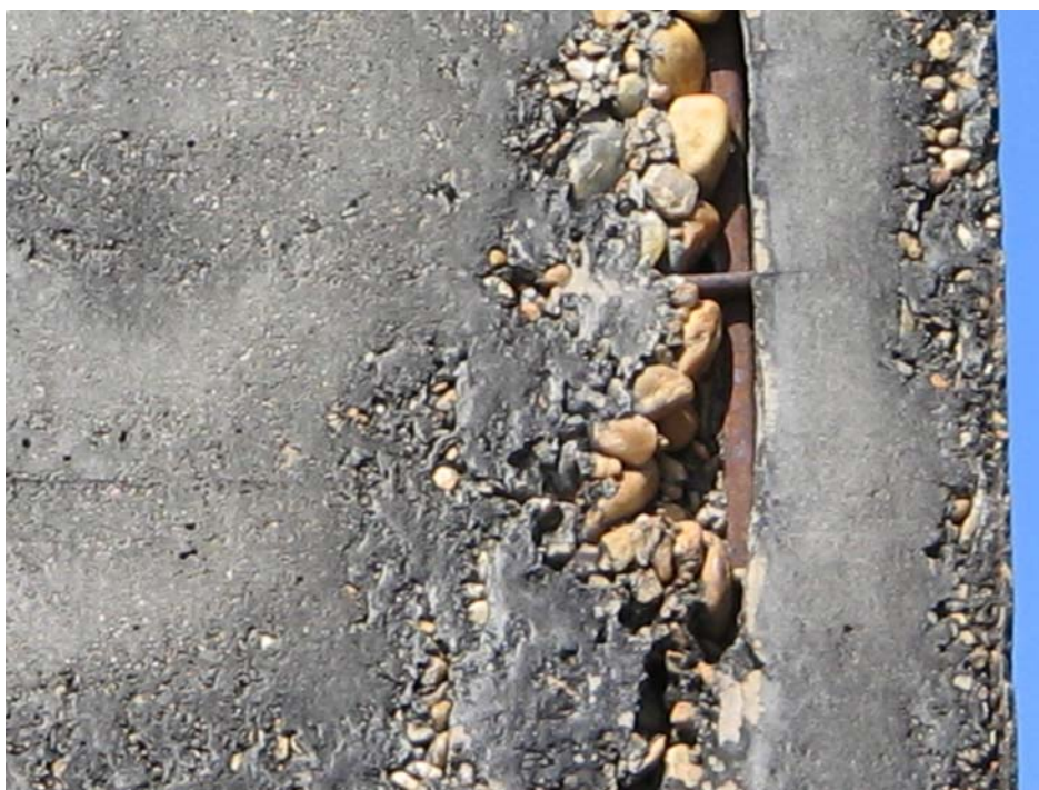
Figura 5.2: Falha de concretagem no pilar. (Andrade, 2006)
