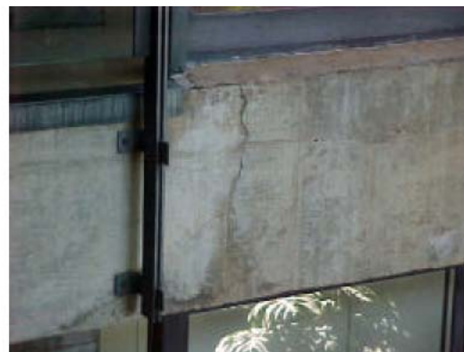
Fig. 22 – Fissura em viga ( F_i=3 )
