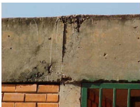
Fig. 37 – Falha de concretagem (Fi=2)
