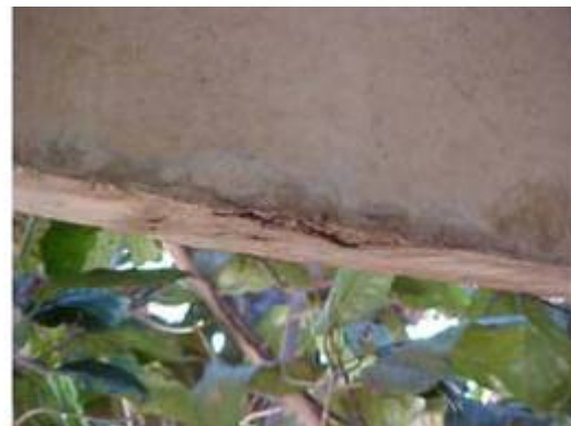
Fig. 5: Corrosão ( F_i=2 ); Esfoliação/Desplacamento do concreto da viga ( F_i=2 )
