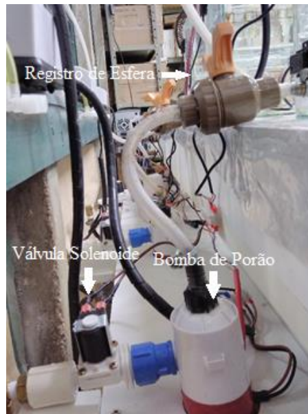
Figura 4.8 - Sistema de descarte do efluente composto pelo registro de esfera, bomba de porão e válvula solenoide.
