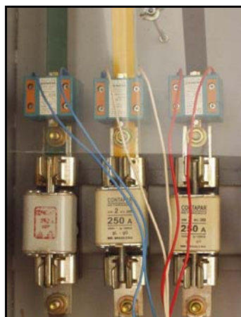
(a) - Transformadores de corrente tipo janela.
