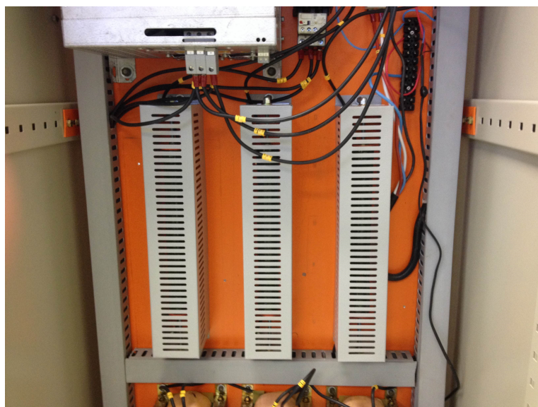
Figura 3.7: Resistores de pré-carga da bancada eólica.
