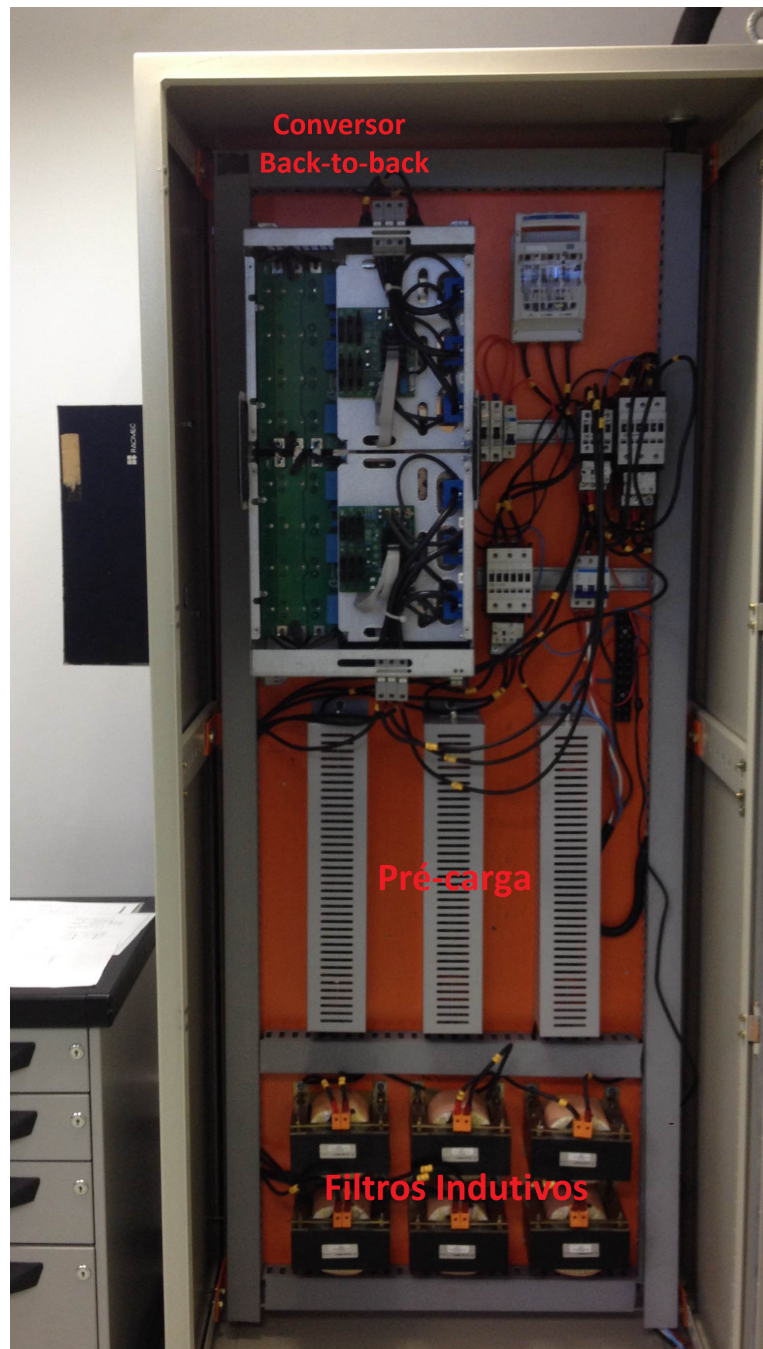
Figura 3.2: Quadro elétrico da bancada eólica.
