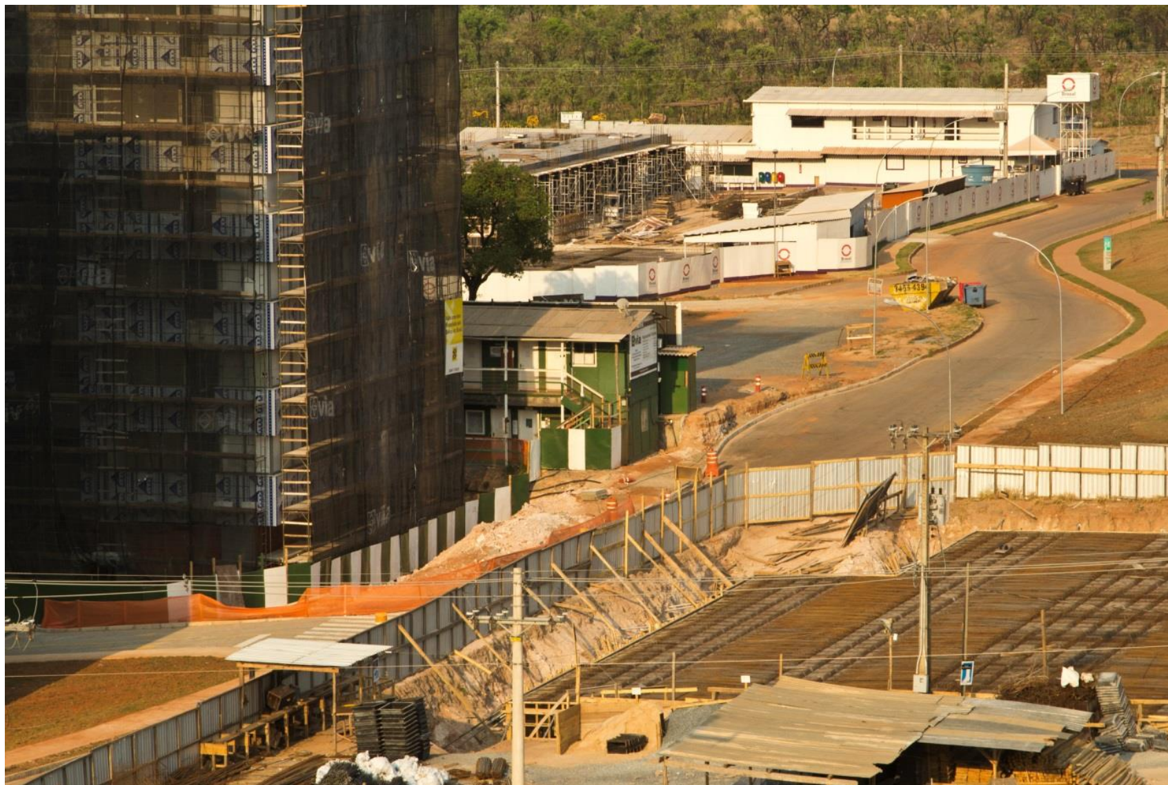
Foto 23 – Não há, no geral, obras aos domingos. Não há operários, diaristas e movimentos incessantes
