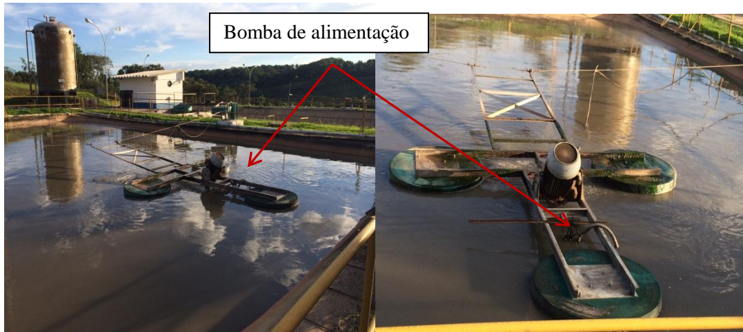
Figura 4.5: Local de instalação da bomba de esgoto bruto da Unidade piloto
