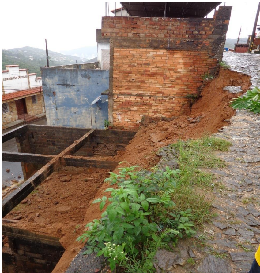
Foto 13: Deslizamento na rua Francisco Isacc em destaque, bairro Alto da Cruz.
