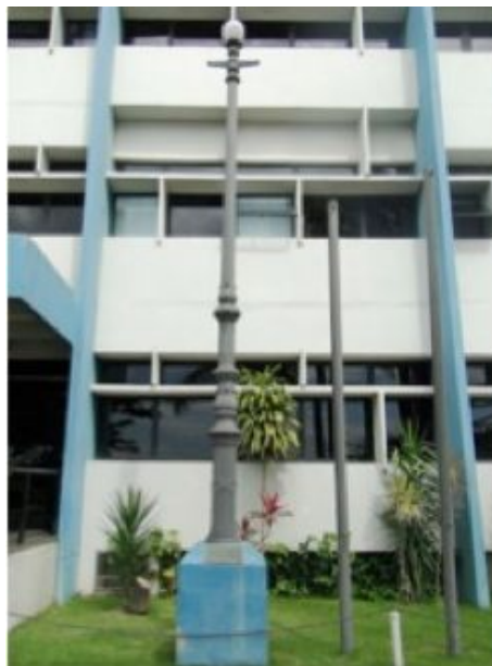
Poste de luz elétrica instalado em Campos dos Goytacazes. Fica no jardim da Delegacia da Receita Federal da mesma cidade. Foto: Farley Derze, 2011.
