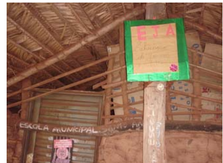
Figura 5.7 – Placa de identificação
