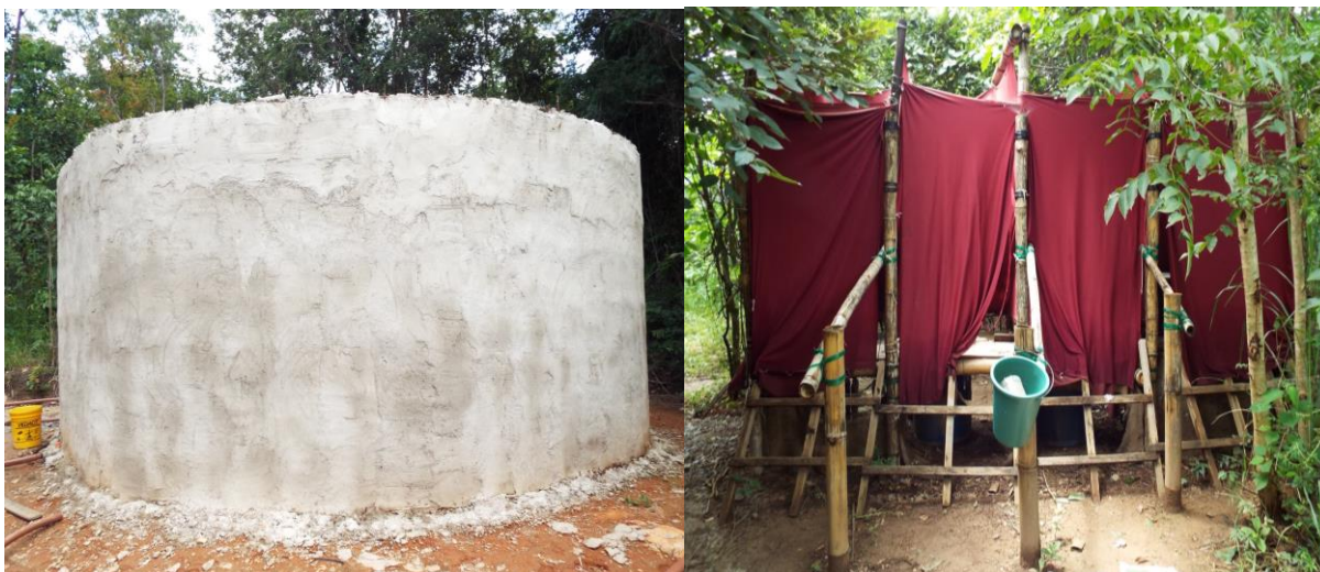
Foto: 47 e 48. Reservatório de água. Estrutura de arame e cimento – reservatório de água e banheiros realizados a partir de técnicas da Bioconstrução para atender a equipe de produção do festival Zuvuya 2014.
