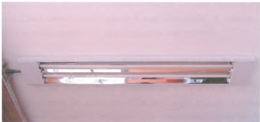
Figura 5.4: Luminária típica – Depois.
