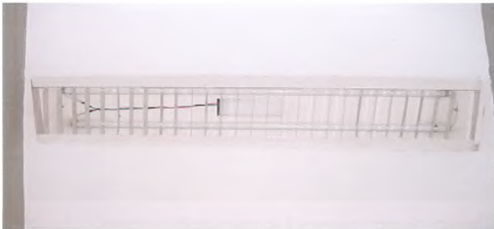
Figura 5.3: Luminária típica – Antes.
