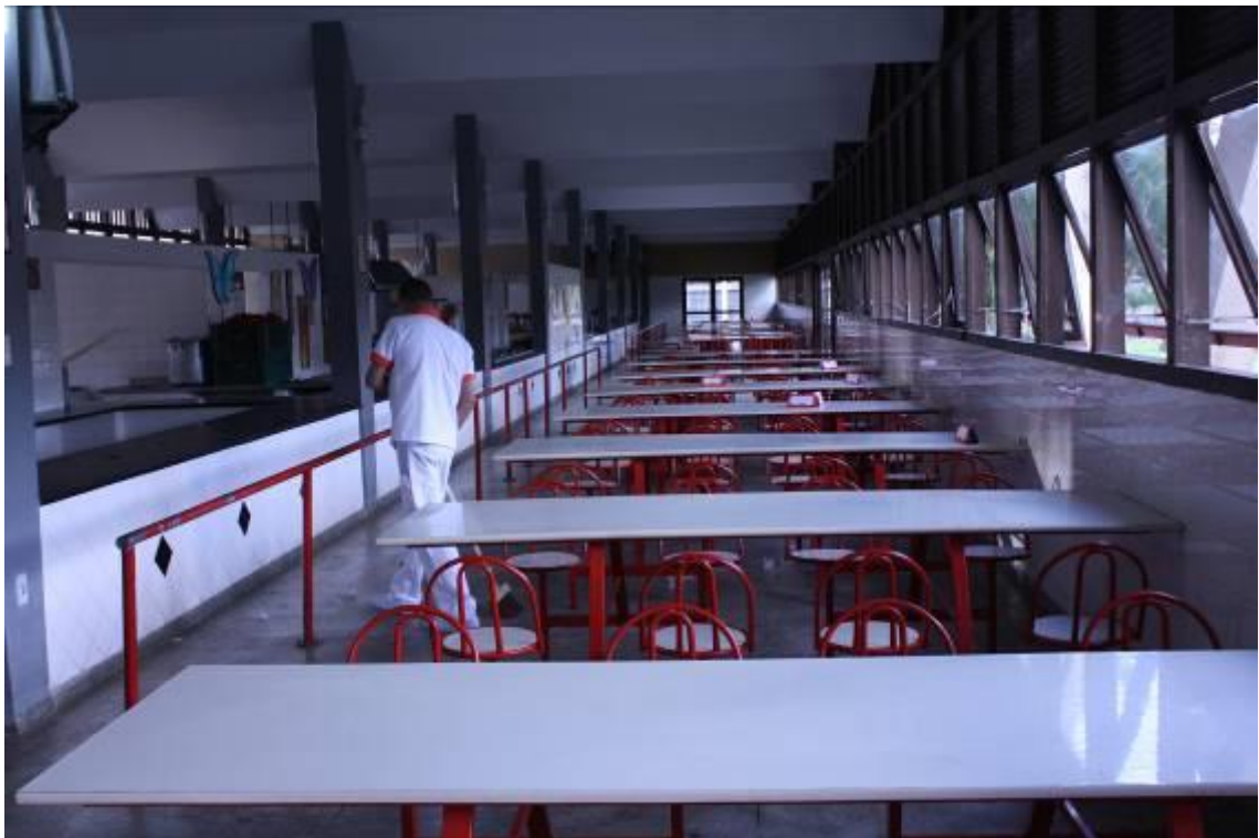
Figura 20: cozinha industrial e refeitório onde são preparadas e servidas as refeições aos mais de dois mil alunos atendidos por esta escola – CECR. Fonte: Cleber Cardoso, 2011.
