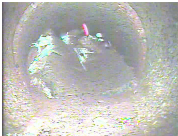
Figura 2. 18 - Rede obstruída por lixo e pedras Fonte: Conter (2008)
