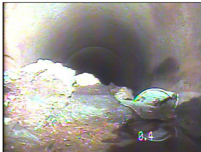
Figura 2. 7 - Pedras e lixo na rede/PV 01 Fonte: Conter (2010)
