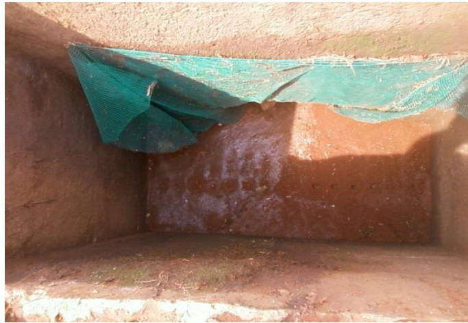
Figura 4.37 - Sedimento ocupando a altura de 5 cm dentro da boca de lobo
