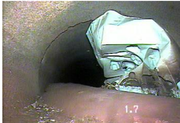
Figura 2. 20 - Presença de lixo após 1,70 metros do início da inspeção Fonte: Conter (2006)
