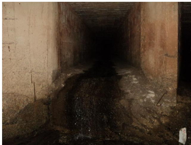
Figura 2. 8 - Vestígio de esgoto sanitário caindo na galeria denominada Iate Clube
