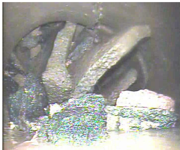
Figura 2. 16 - PV 02 com rachadura Fonte: Conter (2008)
