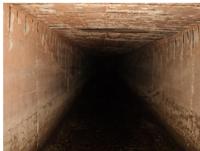
Figura 2. 9 - Armaduras expostas: galeria denominada de Iate Clube
