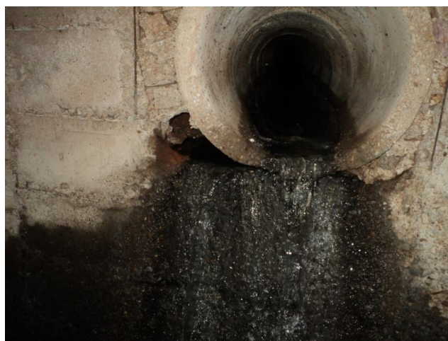
Figura 2. 11 - Vestígio de esgoto sanitário e surgimento de trincas: galeria denominada de UnB
