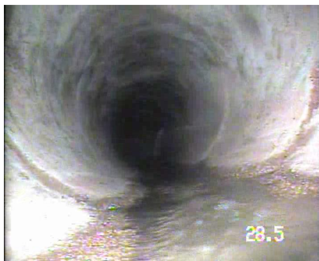
Figura 2. 5 - Trecho em bom estado com presença de esgoto na UnB Fonte: Conter (2010)
