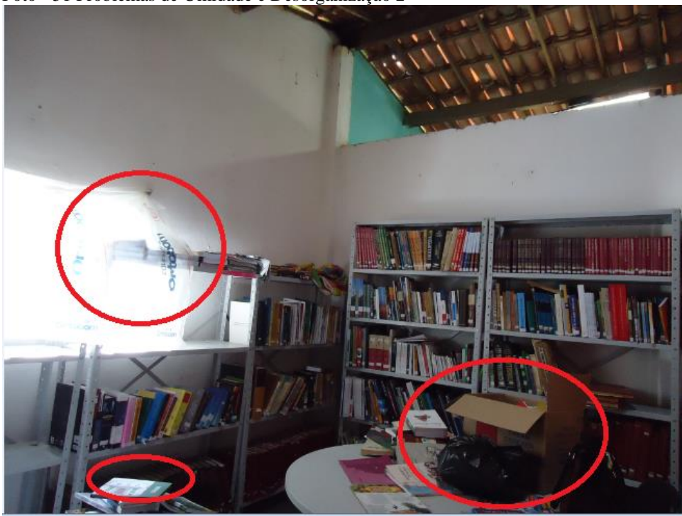
Foto - 51 Problemas de Umidade e Desorganização 2
