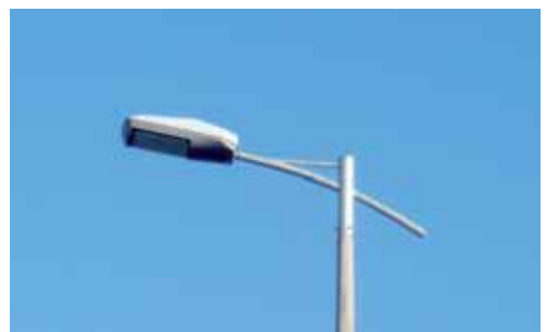
Figura 2.188 - Detalhe da Luminária
