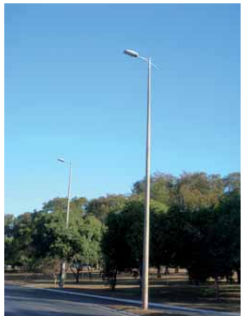
Figura 2.187 - Luminárias no Eixo Rodoviário
