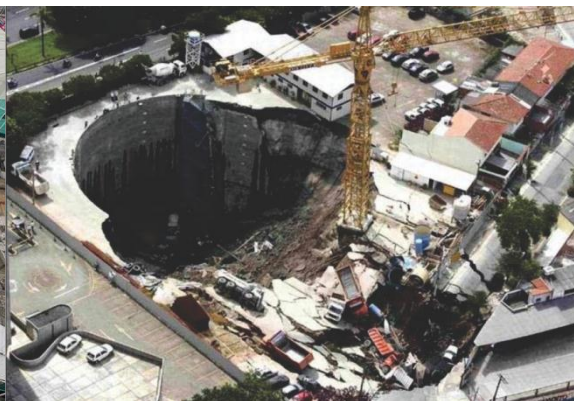
Figura 2.3 – Desabamento da estação 4, no Metrô de São Paulo.
