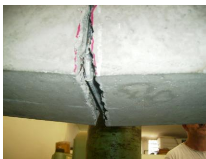
Figura 4.31 – Alargamento na fissura central da viga corroída antes da ruptura do aço.
