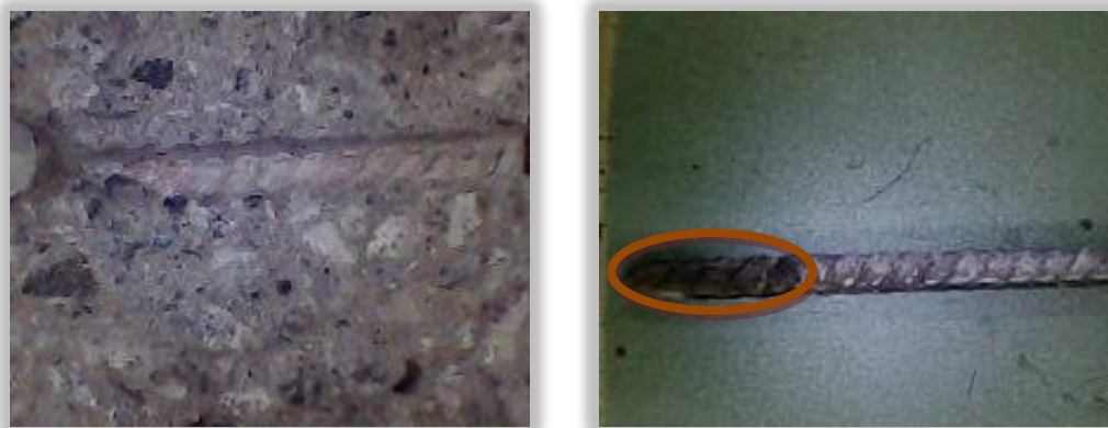
Figura 3.26 – Verificação da ocorrência da corrosão.
