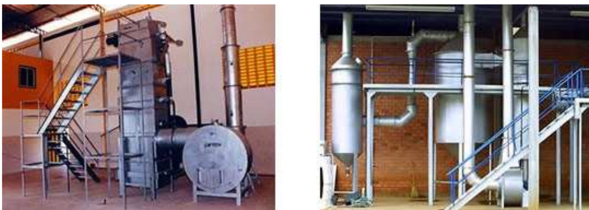
FIGURA 2 - Incinerador (à esquerda) e lavador de gases (à direita).
