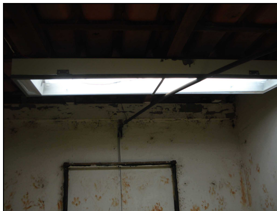
Figura 17. Lâmpada fluorescente modelo D-65 colocada no cambiamento de lobo-guará
